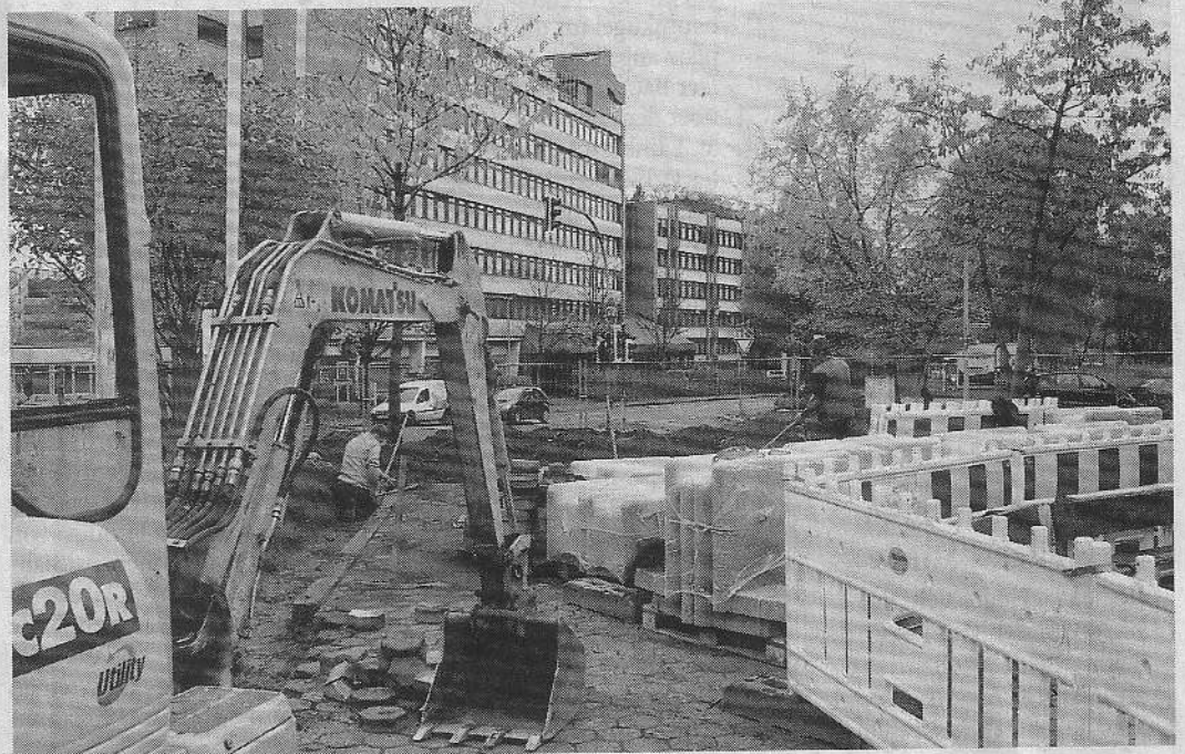
Bezeichnend: Für die Sanierung von Beeten am Neuenhausplatz hat die Stadt die falschen Randsteine bestellt, die nicht zu den bereits liegenden passen. Der Fehler soll korrigiert werden. Foto: Dirk Thomé
